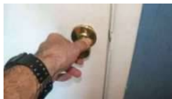
Photo 84-2 Loose Door Knob
